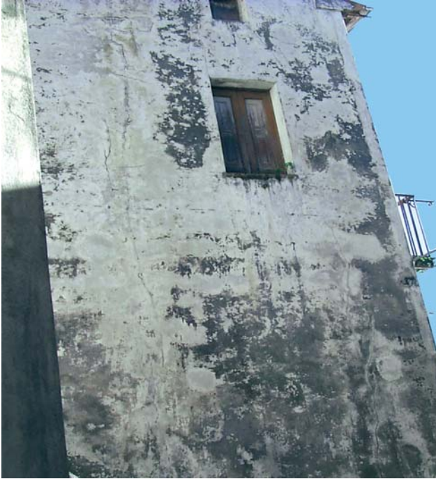
Figura 4.2 Lesioni verticali alla fascia fra le due aperture (tipo1) e lungo la connessione al muro trasversale a sinistra (tipo 6). Livello del danno: D1 (Tortora, CS, 1998)
