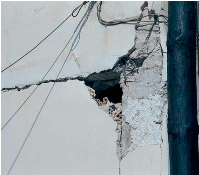
Figura 4.29 Danno al nodo e all'attacco del pilastro con espulsione del materiale fino al nucleo. Livello del danno alle strutture verticali: D4 (Atene, 1999)
