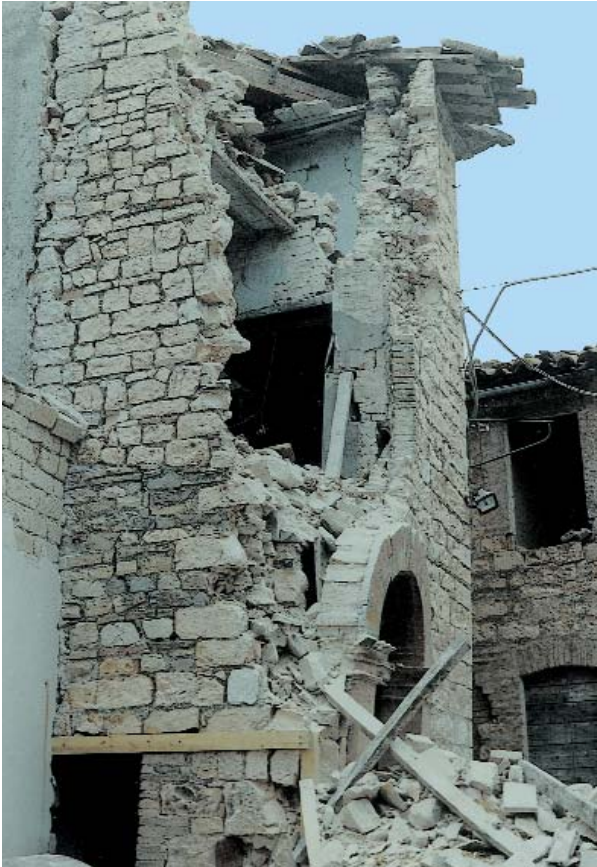
Figura 4.24 Crollo parziale di muratura e copertura. Livello del danno alla parete: D4-D5. Livello del danno alla copertura: D4-D5 (Busche, PG, 1998)
