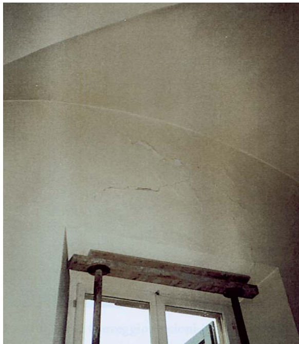
Figura 4.3 Lesione in corrispondenza all'architrave verticale (tipo1) e diagonale (tipo2); puntellamento cautelativo. Livello del danno: D1 (Correggio, RE, 1996)
